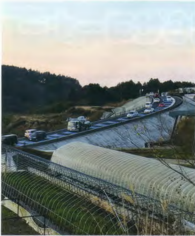
仮設道路 大切畑ダムを迂回して南阿蘇(嶺山トンネル)へとつながる新道
